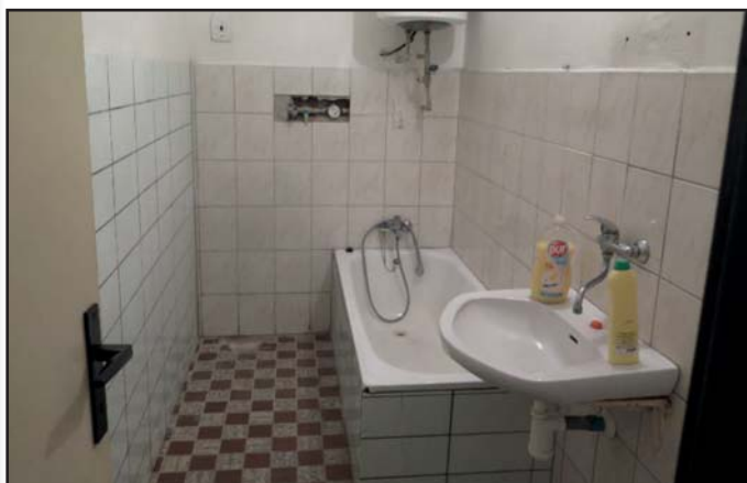
Koupelna před opravou
